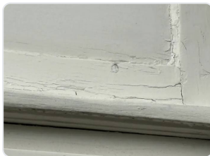
Scheur in verfsysteem kozijn
