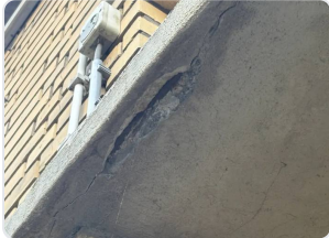
Scheur in latei boven kozijn
