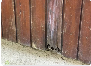
Houtrot onderzijde deurblad
