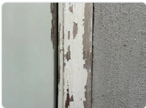
Afbladderende verf deurstijl
