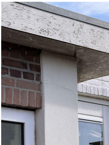
Situatie gevel: diverse infiltratiepunten waardoor capillaire vochtdoorslag mogelijk is.
