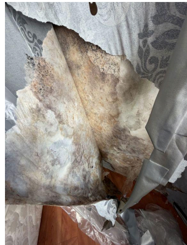
Ruimte met vochtschade.
