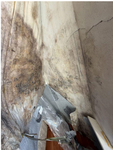
Ruimte met vochtschade.
