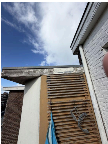
Boeidelen zijn slecht onderhouden en kunnen infiltratiepunten bevatten waardoor vocht naar binnen slaat.
