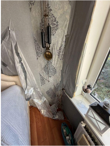
Ruimte met vochtschade.
