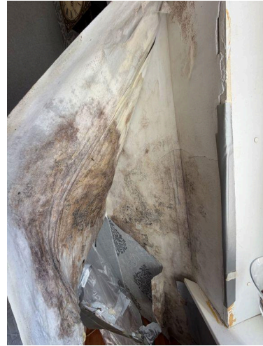
Ruimte met vochtschade.
