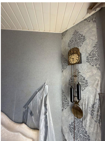
Ruimte met vochtschade.
